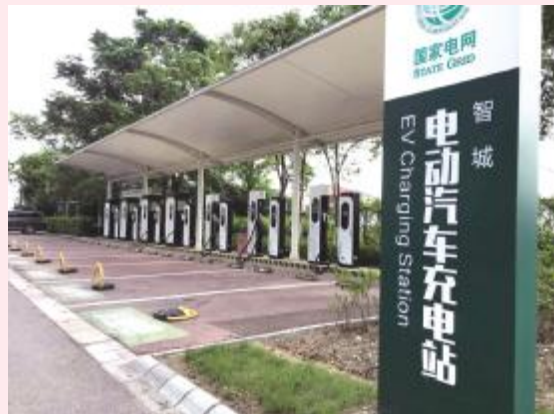
2018年6月15日,电力电子正式承接浦东新南汇地区12个电动汽车充电站运维。自此,电力电子共承接市北供电公司、浦东供电公司辖下67个充电站运维工作。
